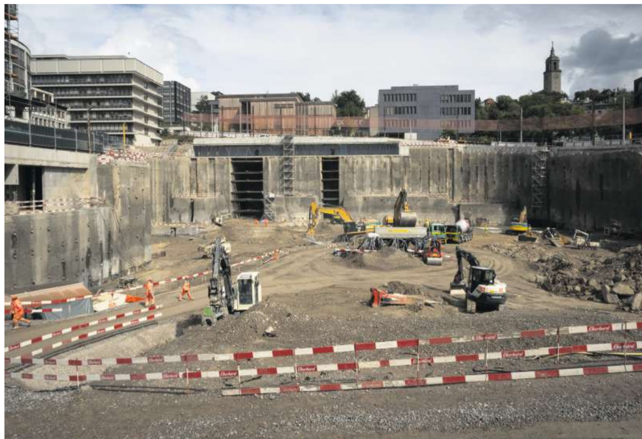
An der Gloriastrasse wird ein neues Spital in den Hang gebaut. Der Aushub dauert noch bis in den Spätherbst.
