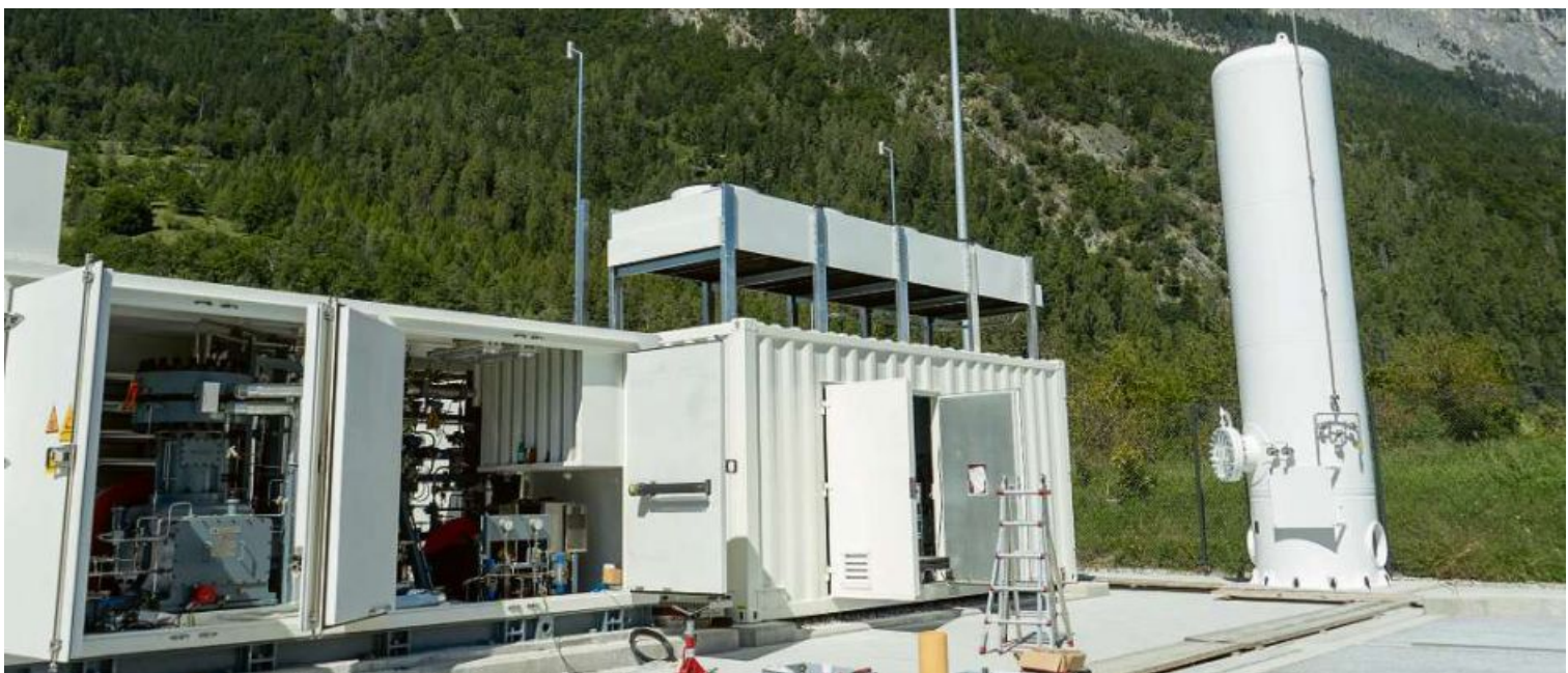
Die Wasserstoffanlage von nahe.
