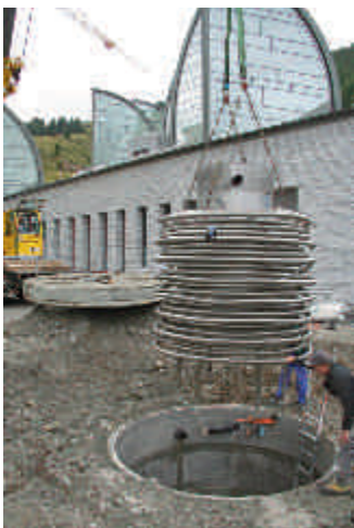
Wärmerückgewinnung aus Abwasser mit dem FEKA-System.
