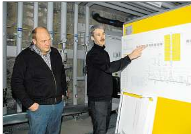
Innovative Technik: Projektleiter René Meier (r.) erklärt Andrea Löttscher vom Amt für Energie das Versorgungskonzept. (nw)
