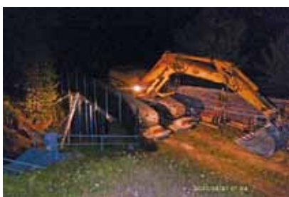
Mit Spezialstützen wurde die Schlittelbrücke abgestützt, so dass der 25 t Bagger die Brücke queren konnte
