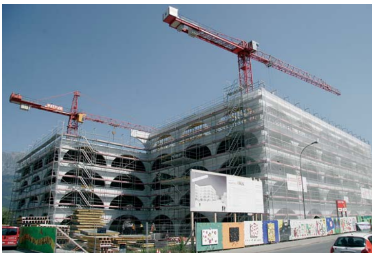
Gesamtansicht mit Annex- und Hauptbau. Beim Annexbau fehlen noch die Bogenelemente des letzten Geschosses
