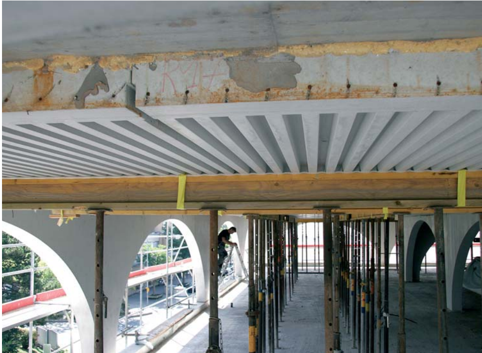
Die Deckenelemente dienen als verlorene Schalung im Bau und als Akustikdecken im Betrieb
