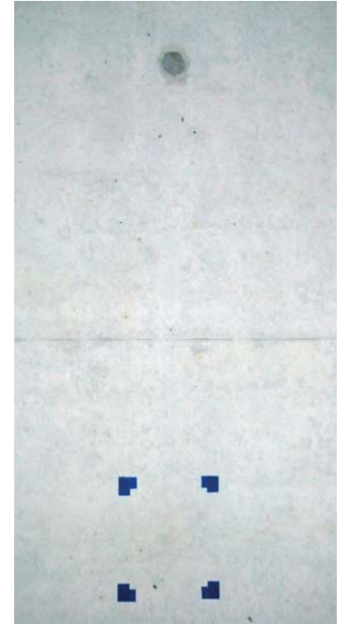
Oben eine vermörtelte Bindstelle, unten im markierten Bereich eine vom Restaurator fertig behandelte
