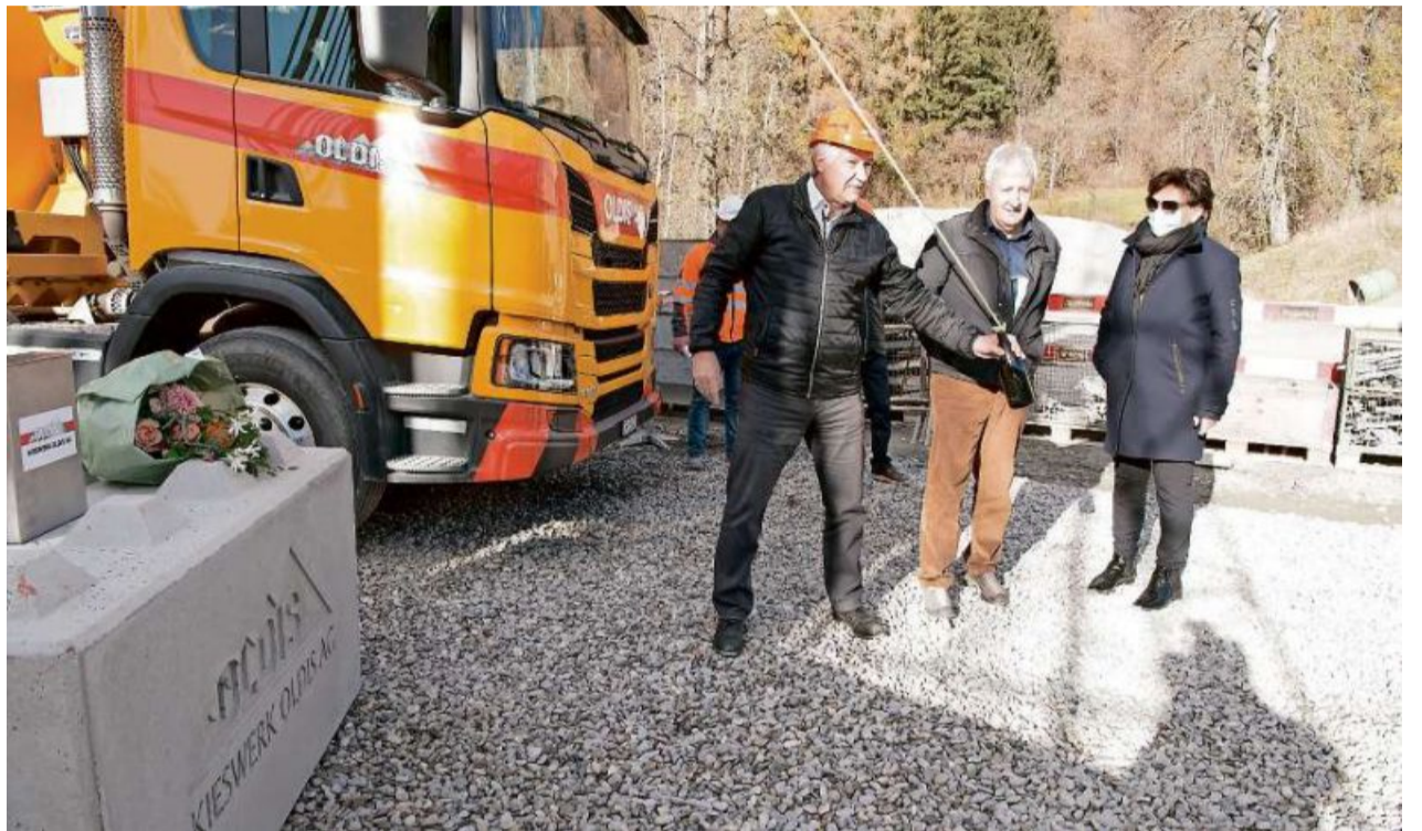
Es geht los: Verwaltungsratspräsident Hans Geissler (links), Bürgerpräsident Hans Gasser und Gemeindepräsidentin Gerda Wissmeier legen symbolisch den Grundstein zum neuen Kieswerk in Haldenstein. Bild Philipp Baer
